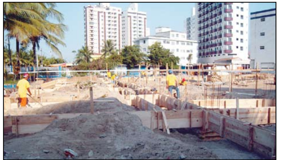
Espaço em obras, em frente aos apartamentos antigos, onde serão construídos o novo restaurante e a quadra poliesportiva
